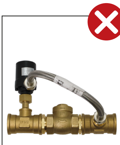
Wirnik pompy w pionie - utrudnione odpowietrzanie.
